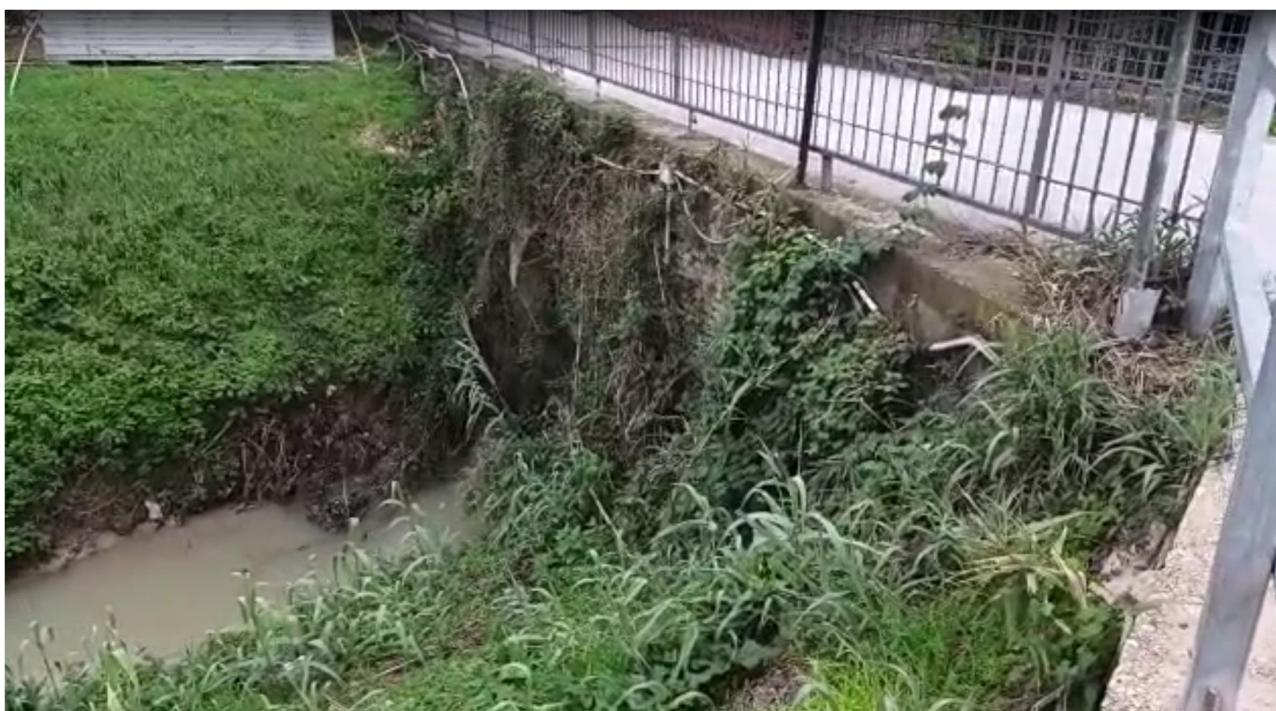
Foto n. 7 - Scorcio prospettico di valle dell'attraversamento fossato della variante alla S.R. 602, dove si evince la tipologia costruttiva, in muratura ad arco
