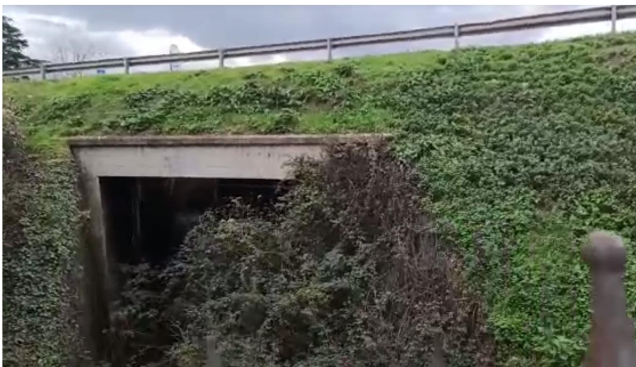
Foto n. 9 - Scorcio prospettico di valle dell'attraversamento fossato della S.R. 602 (sovrastante), dove si evince la tipologia costruttiva, in c.a.
