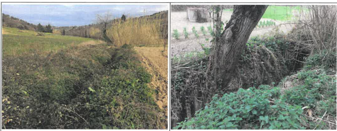
Foto 7.1, 7.2, 7.3, 7.4: Le scarpate di erosione fluviale lungo il tratto che va dalla fossa imhoff Pozzo Nuovo alla stazione di sollevamento 1
